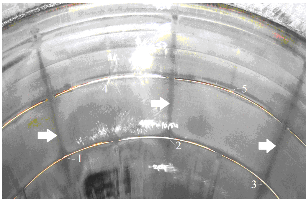
Рис.3.16. Сліди натирань на дзеркалі ЦВ які проходять через точки підведення мастила (1,2,3) нижнього мастильного пояса (точки 4,5 підведення мастила верхнього пояса).
