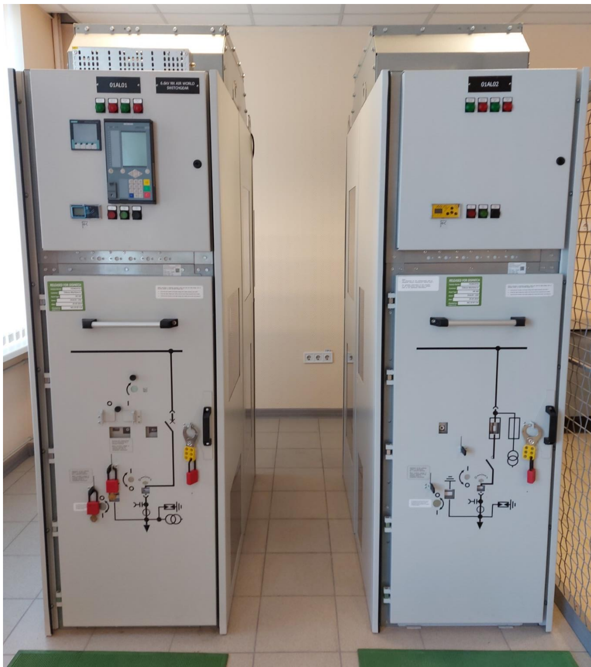
Рис. 1 – Загальний вигляд секцій КРП
