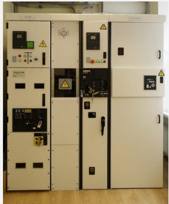
Рис.7 – Високовольтні секції СЕУ: Incomer panel; trans panel; motor fider panel; soft- starter panel.
