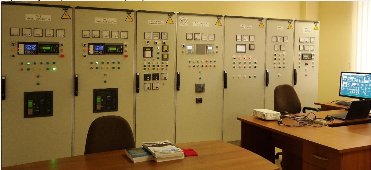
Рис.1 – ГРЩ суднової електроенергетичної установки (СЕУ): MSB1, MSB2 – секція управління ДГ1 і ДГ2; MSB3 – секція синхронізації і збору помилок; MSB4 – секція корекції коефіцієнту потужності; MSB5 – секція навантажень; MSB6 – секція берегового живлення; MSB7 – секція АДГ електростанції.
